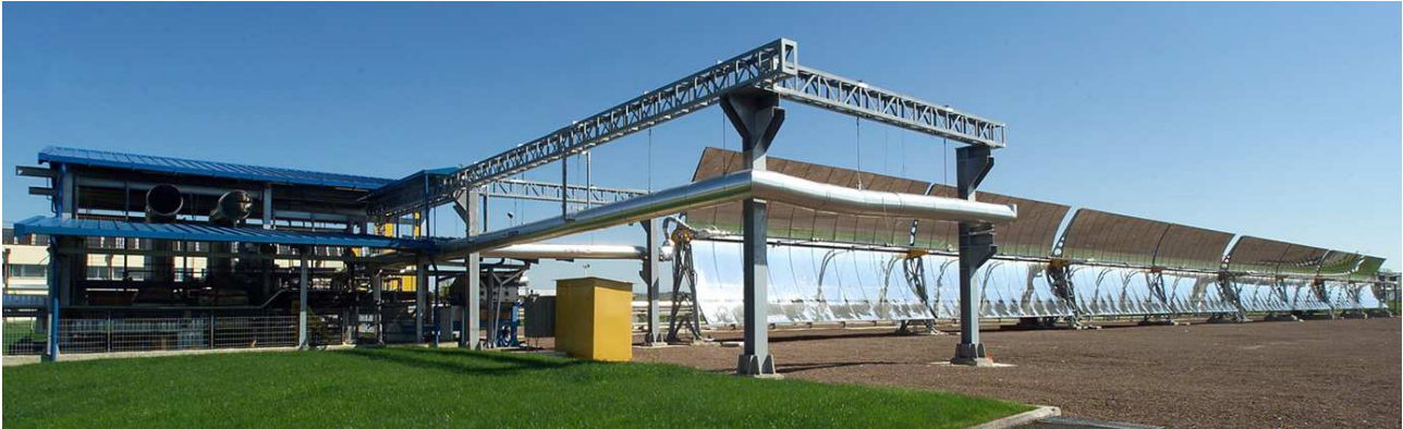
Impianto Prova Collettori Solari (PCS) al C.R. Casaccia - ENEA
